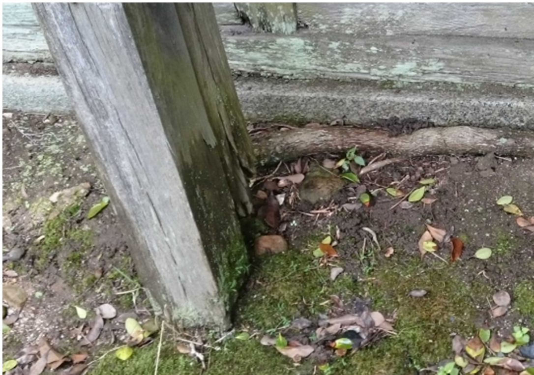
塀の劣化状況（支えの部分が浮いている）
