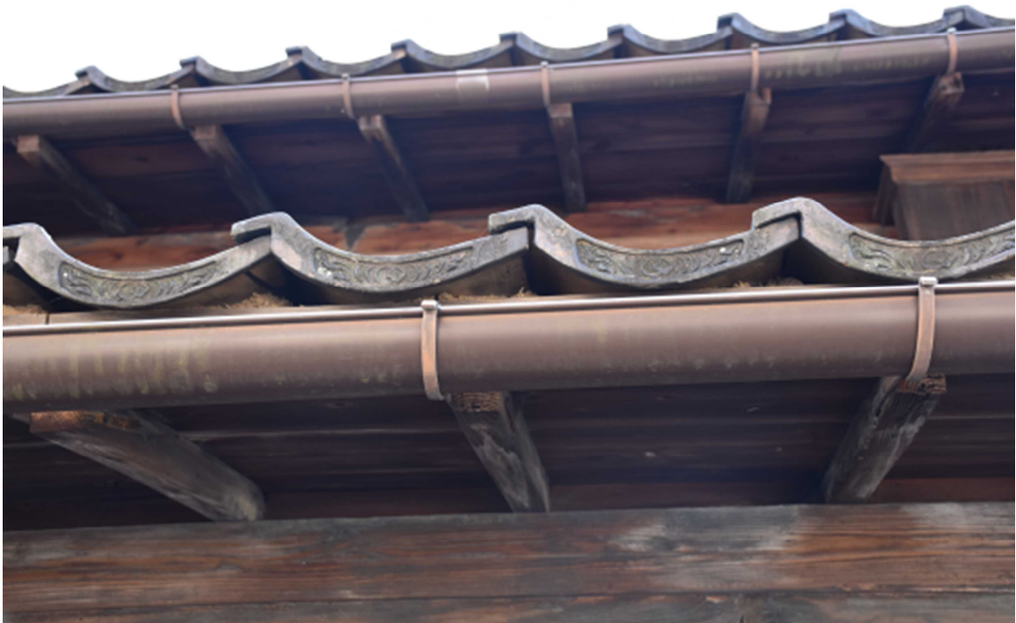
劣化状況（葺き土が減少し、瓦が下にずれている）
