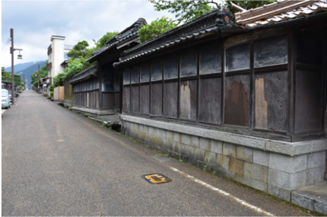
塀の劣化状況（腰板が欠損）
