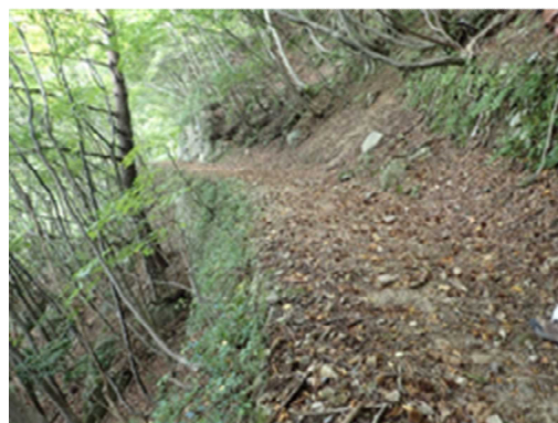
崩落もある沖ノ山森林軌道跡の遊歩道
