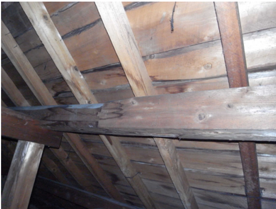
雨漏りのシミ
