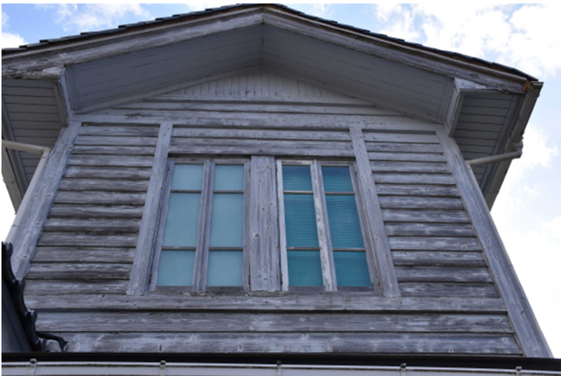
劣化状況（塗装が剥がれている）
