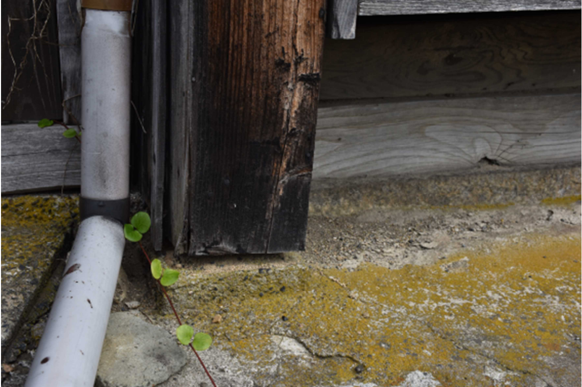
劣化が進み支柱が浮いている
