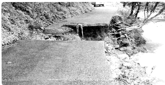
洗掘されたセラピーロード進入路
