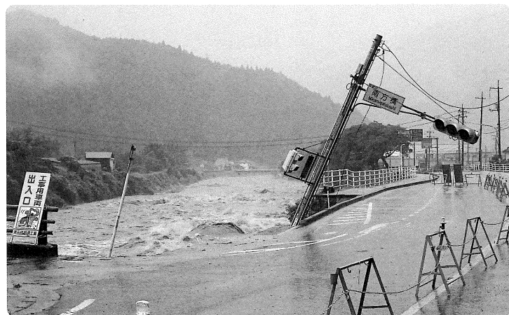
護岸が崩落して信号機も落下(上市場地内)
