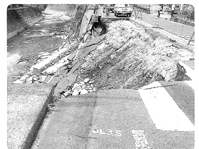
旧山郷小学校前の国道373号崩落
