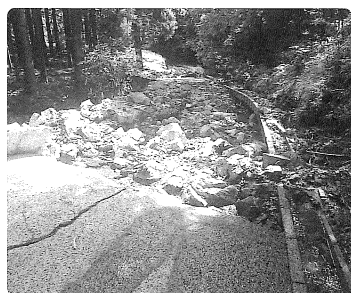
林道の被災現場＝駒帰地内
